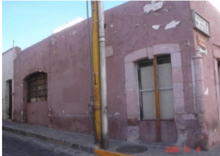
CASA HABITACIÓN EN VILLALPANDO Y CALLEJÓN DEL IDEAL, EN PROCESO DE DETERIORO
