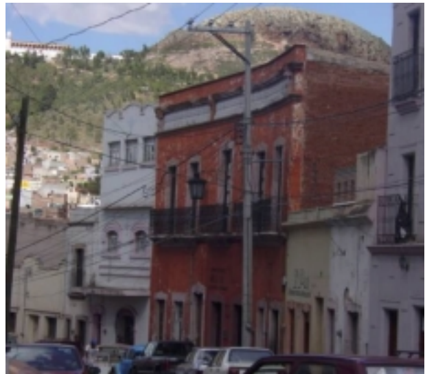
AV. MORELOS, ALTERACIONES Y DETERIORO DEL PATRIMONIO EDIFICADO
